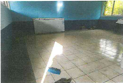
Foto 2: Sustitucion de piso cerámico en mal estado en aula principal, 56 m2.
